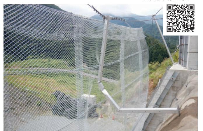
支柱破損状況
