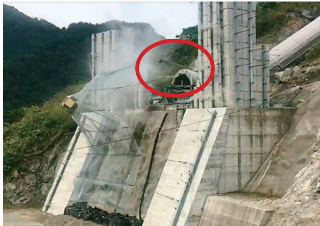
支柱に有意な傾斜が発生した事例
