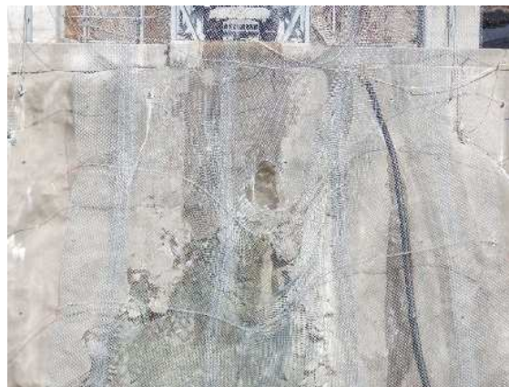
重錘衝突部の損傷状況
