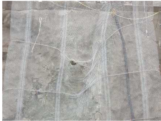
重錘衝突部の損傷状況
