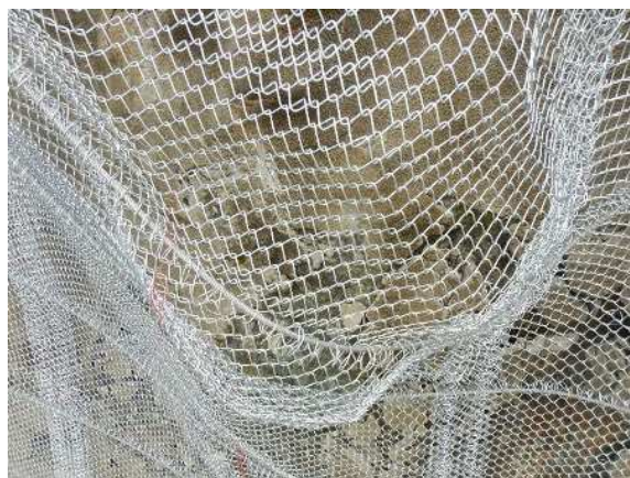
重錘衝突部の損傷状況
