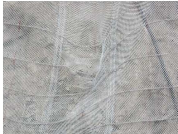
重錘衝突部の損傷状況
