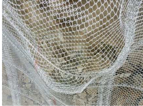
重錘衝突部の損傷状況
