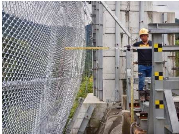
重錘衝突位置確認
