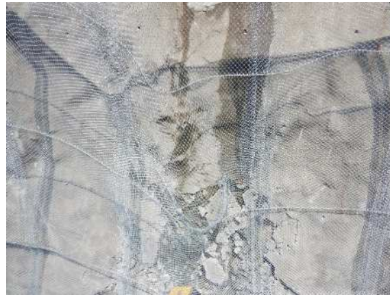
重錘衝突部の損傷状況
