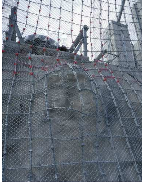
重錘衝突部の損傷状況
