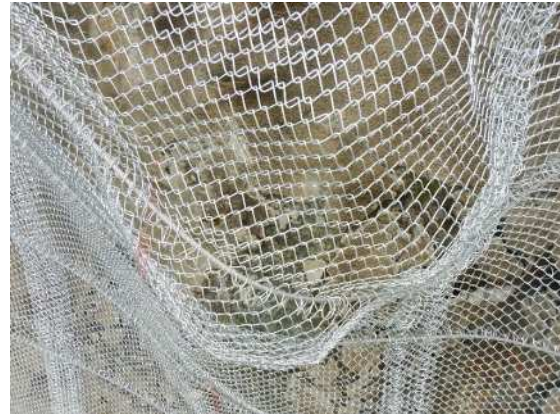
重錘衝突部の損傷状況
