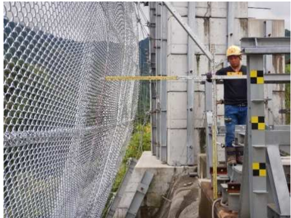
重錘衝突位置確認
