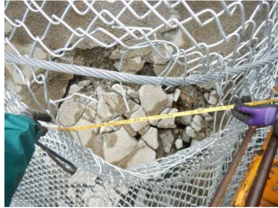
重錘衝突部の損傷状況
