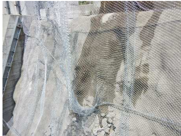
重錘衝突部の損傷状況
