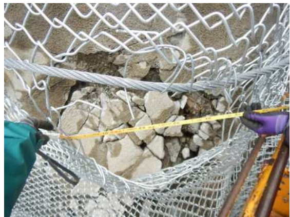
重錘衝突部の損傷状況
